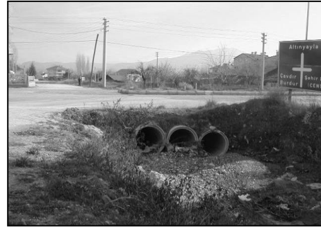
Fotoğraf 9. Burdur İli Gölhisar İlçesi şehir içi derelerinin yolu kutu menfezle geçmek yerine büzle geçişi
